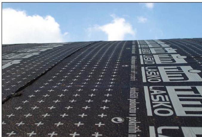
Izoself samolepilni bitumenski trak je nameščen direktno na Stiropor toplotno izolacijo po celotni površini, sledi še zaključni bitumenski trak Izoelast Reflex.
