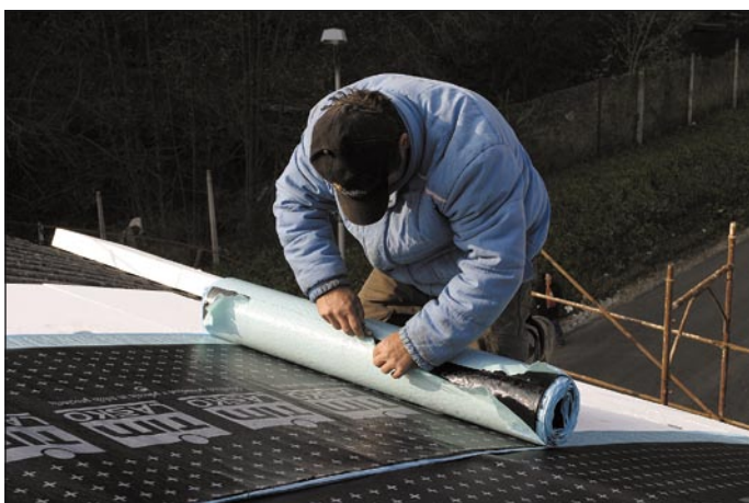
Odstranjevanje poveščene zaščitne folije in ustvarjanje prekopov v prečni in vzdolžni smeri.
